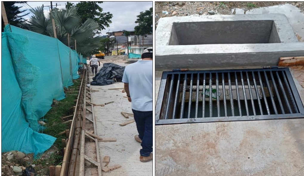
Ilustración 26. Sardinel de concreto y sumidero
