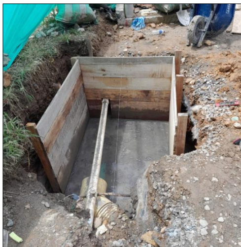
Ilustración 31. Presencia de tubería no prevista en los planos
