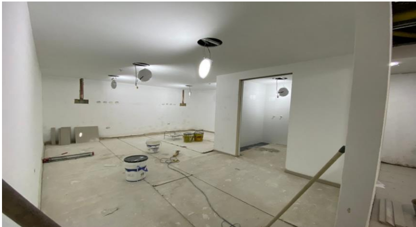
Figura 55. Ensayo de funcionamiento de red eléctrica.
