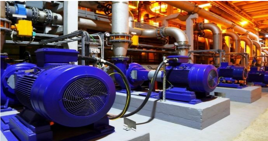
Figura 14. Sistema hidráulico con bombas.
