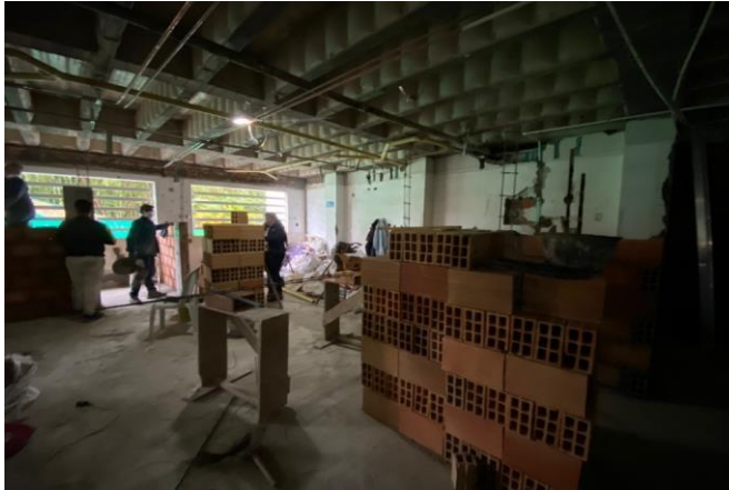
Figura 47. Muro en bloque
