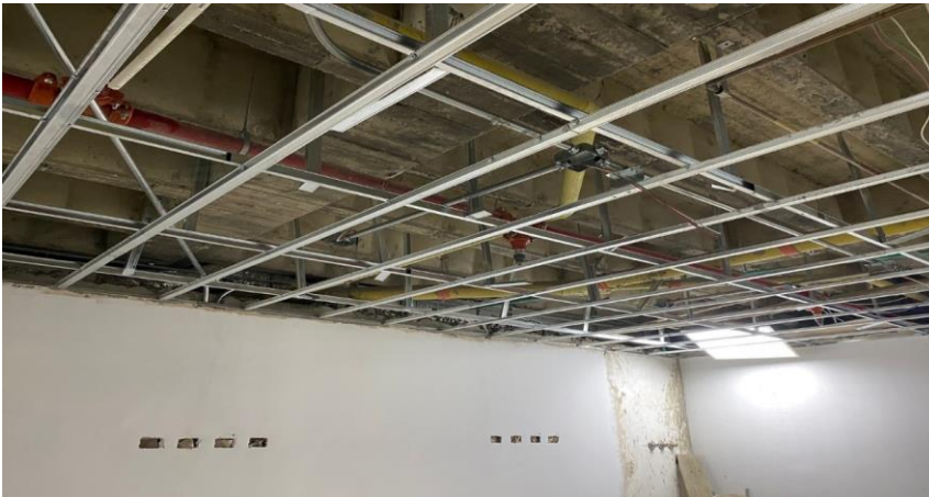
Figura 51. Red contra incendio instalada
