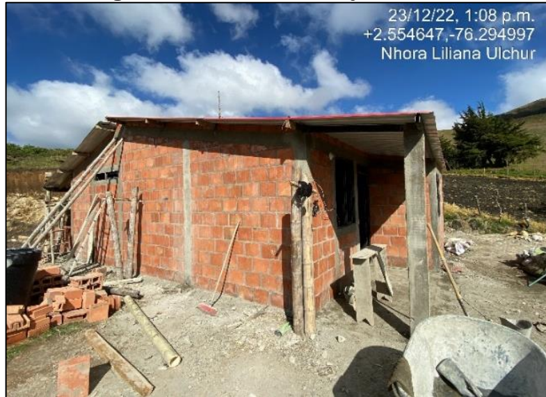
Figura 36. Cubierta en teja de acero
