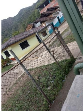
Parte inferior izquierda con malla en mal estado
