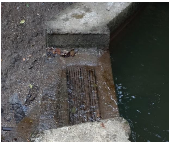
Rejilla en mal estado en la bocatoma.
