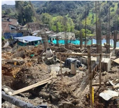
Imagen 8 Avances en la construcción de la plaza de mercado de Bolívar Cauca
