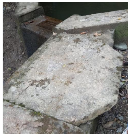
Tapa del tanque de bocatoma en mal estado.
