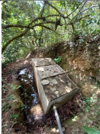
Tapa en mal estado del desarenador
