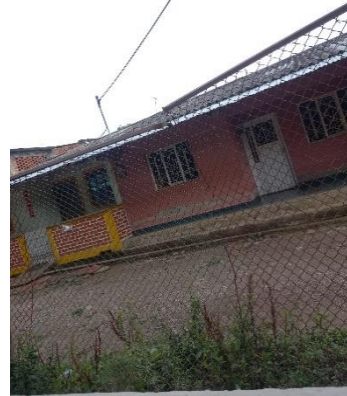
Malla con carencia de tubería
