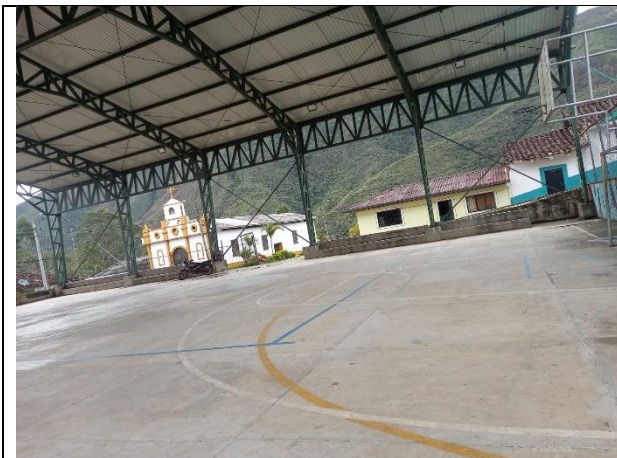
Parte del polideportivo que carece totalmente de ,malla y tubería.
