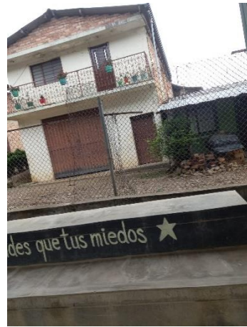
Parte media derecha con malla en mal estado.
