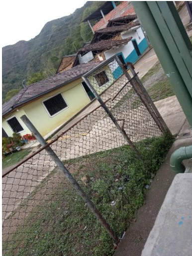
Imagen 30. Carencia de cerramiento en el polideportivo
