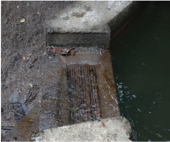
Imagen 22. Rejilla en mal estado en la bocatoma
