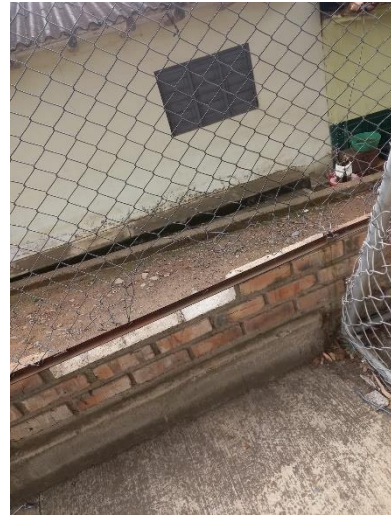
imagen 31. Enmallado puesto por la misma comunidad, deteriorado
