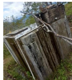
Imagen 27. Tanque de almacenamiento en mal estado.
