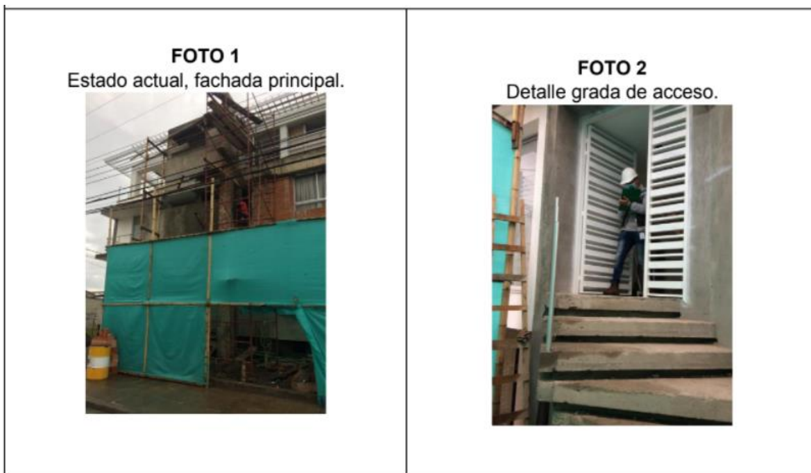
Imágenes 6.2 Estado actual obra menor
