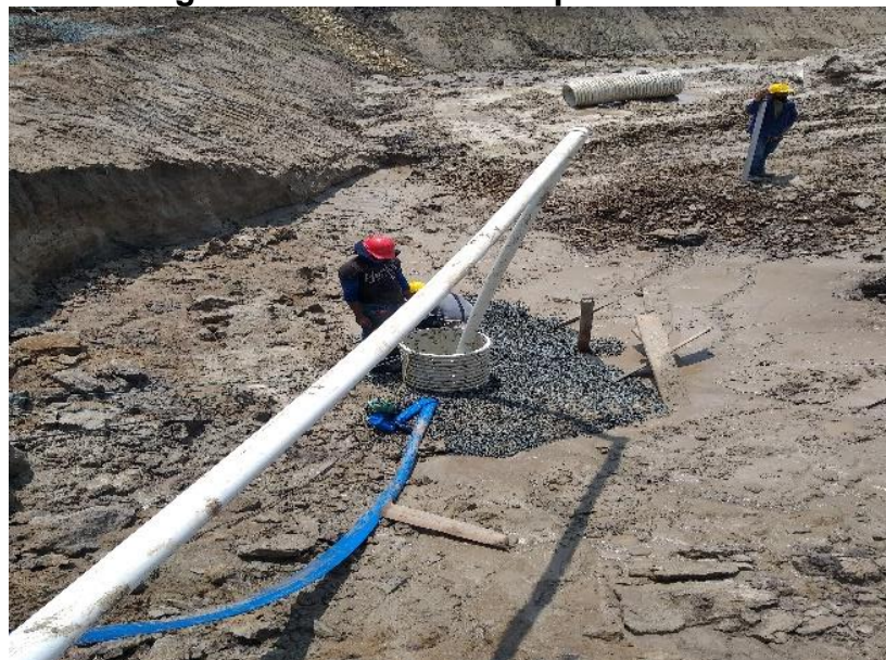
Figura 10 Punto de Achique Y Bomba
