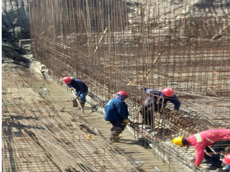
Figura 31 Amarre de acero Cárcamo Cuarto de Maquinas
