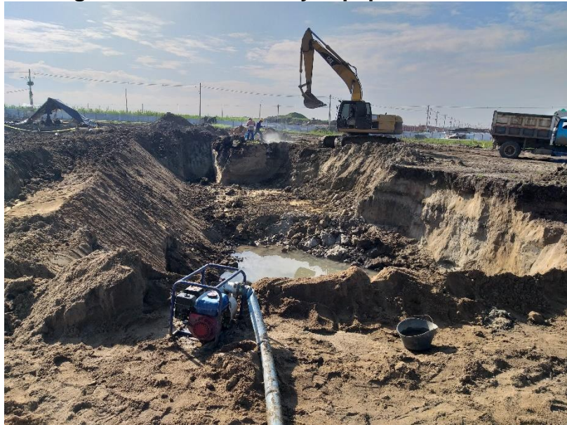
Figura 8 Nivel Freático y Equipo de Bombeo
