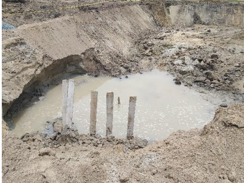
Figura 9 Desprendimiento del Terreno
