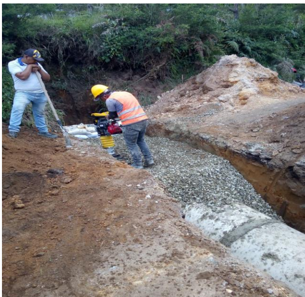
Figura No. 14 Instalación relleno y compactación de material triturado de ¾” para atraque de tubería de 36”
