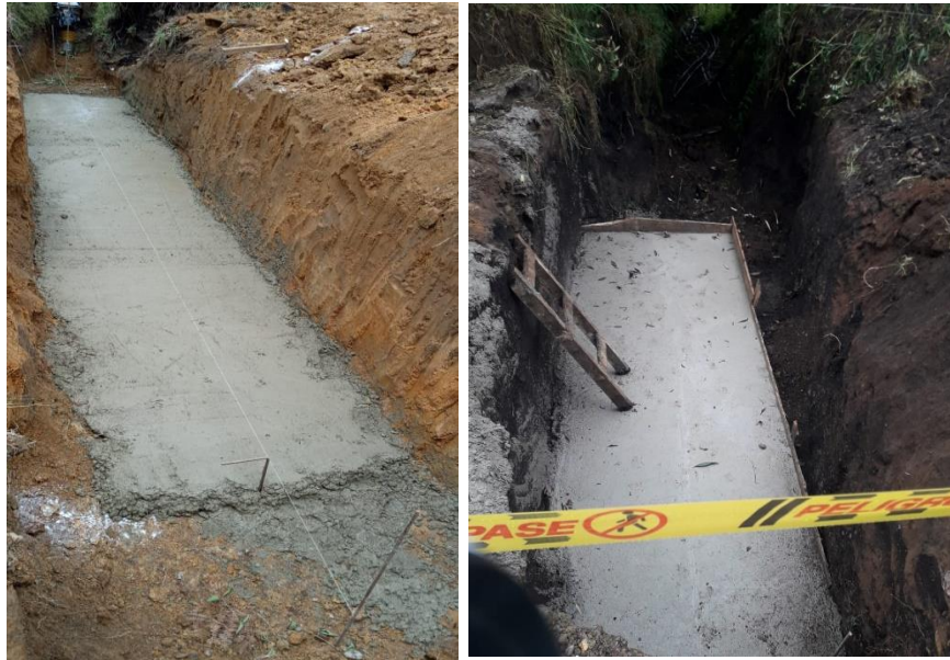
Figura No. 13 Instalación de solado de 140 kg/m 2 para estructura de soporte de tubería de 36" y de limpieza para estructuras de alcantarillas
