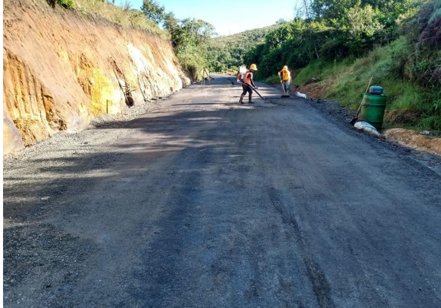
Figura No. 30 Barrido de base, preparación de base para riego de imprimación
