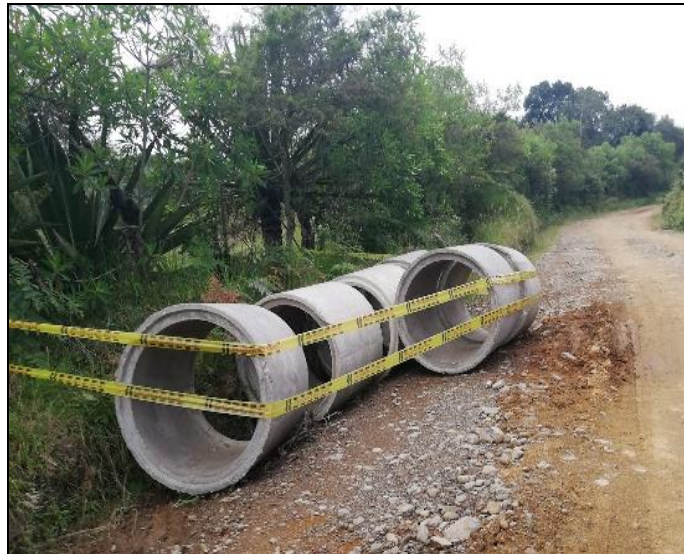
Figura No. 9 Traslado y señalización de la tubería de 36" en concreto reforzado k1+216
