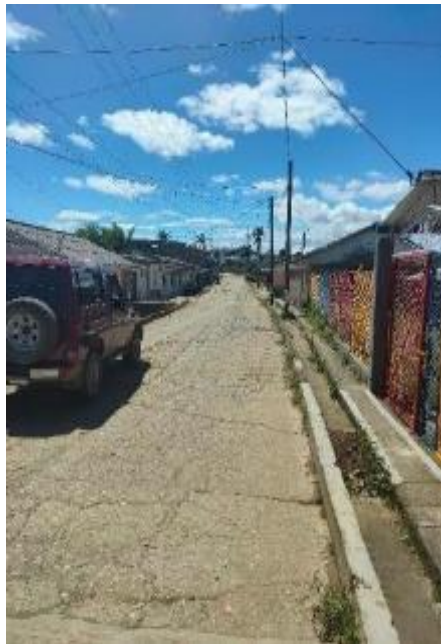
Ilustración 32. Estado inicial del pavimento en el tramo 5 Fuente: Informe de interventoría
