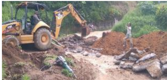
Ilustración 115. Demolición del pavimento para la excavación de la alcantarilla Fuente: Elaboración propia
