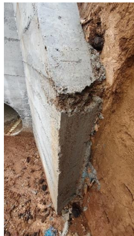
Ilustración 141. Estado de los muros laterales de descole Fuente: Elaboración Propia
