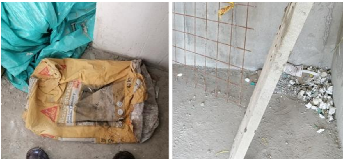
Ilustración 65. Residuos mal ubicados
