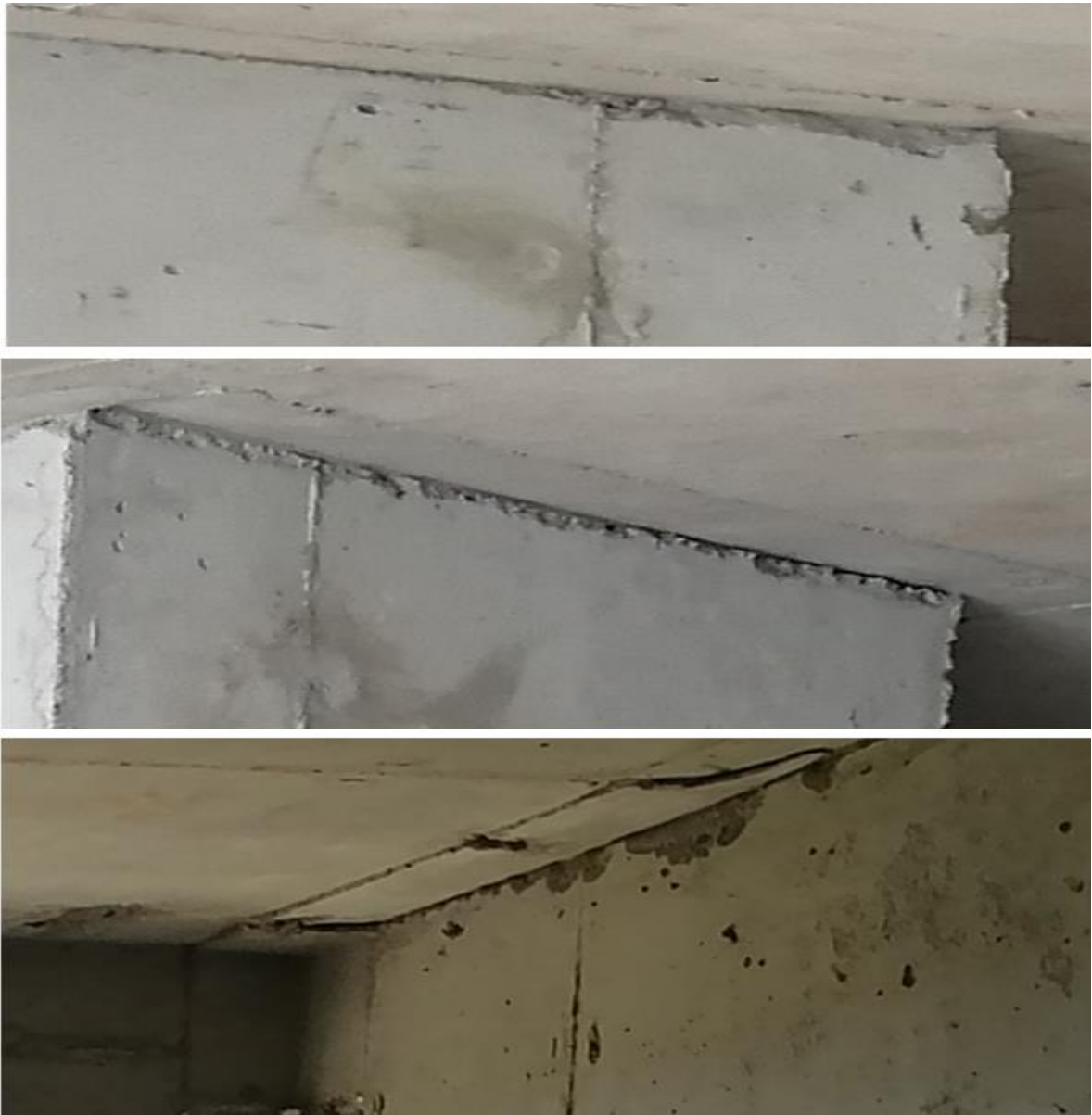
Ilustración 44. Defectos en el acabado
