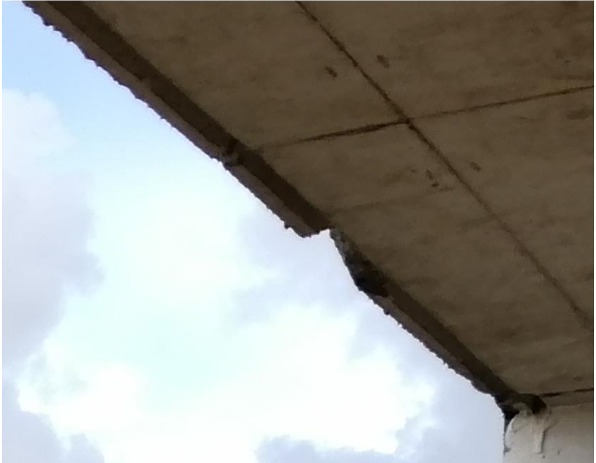
Ilustración 46. Losa de balcón despicada
