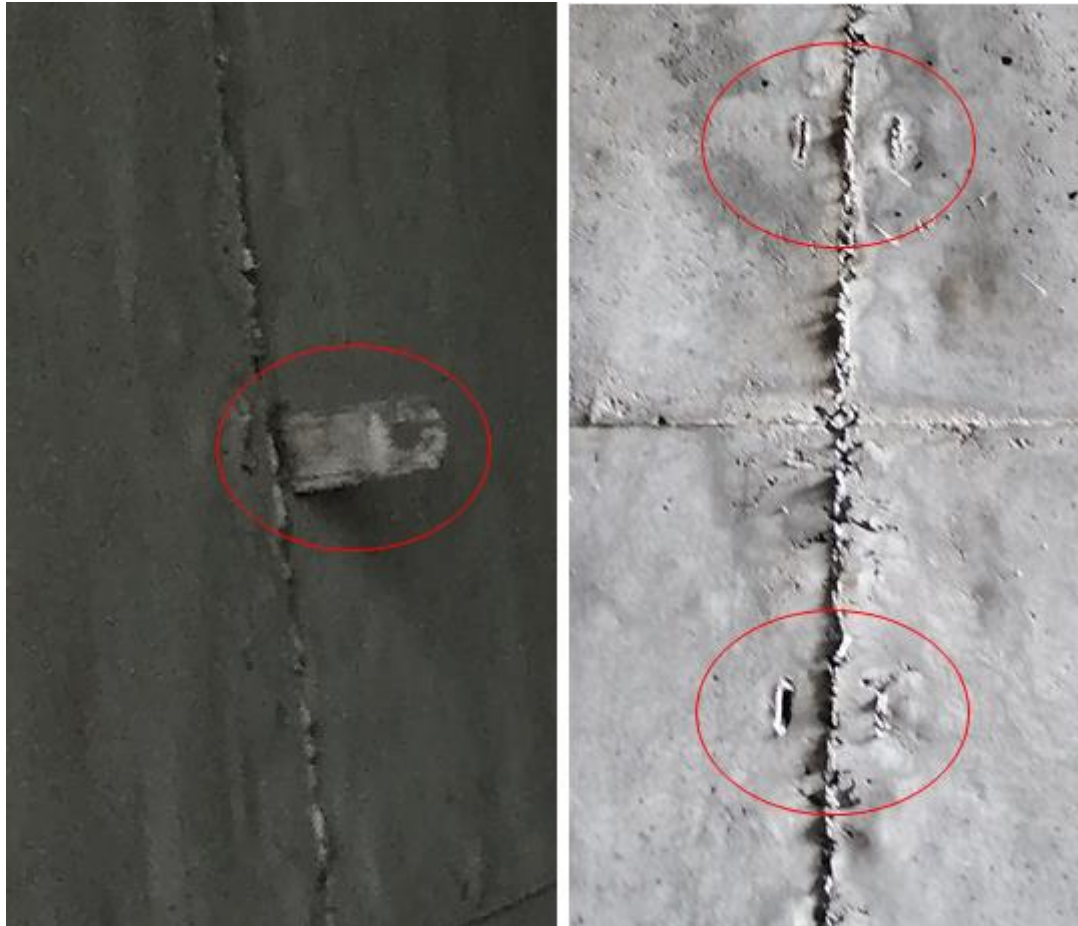
Ilustración 47. Corbata sin retirar y orificios de corbatas
