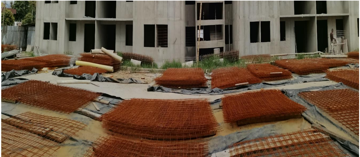
Ilustración 39. Depósito de mallas
