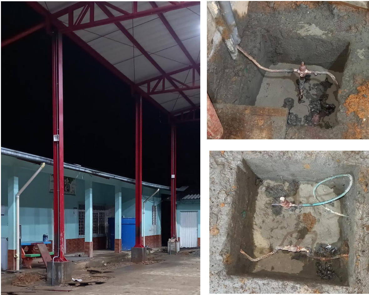
Figura 25. Bajantes en tubería para descargas y cajas de inspección para salida de la descarga eléctrica
