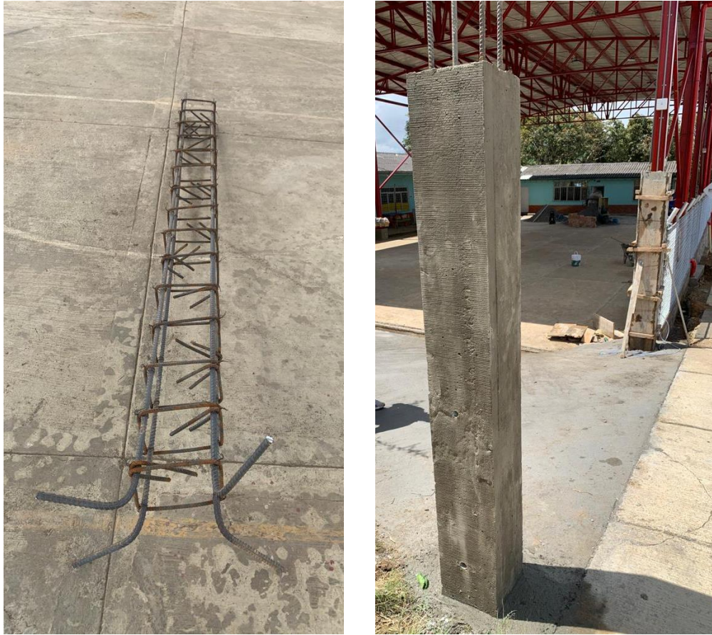
Figura 14. Construcción de columnas en concreto para el soporte de la puerta de acceso
