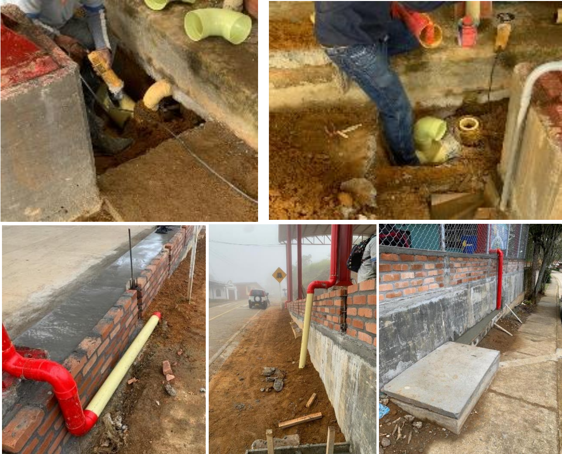
Figura 21. Instalación de bajantes de 4" en tubería novafort de 6" y descarga de agua en caja principal de salida
