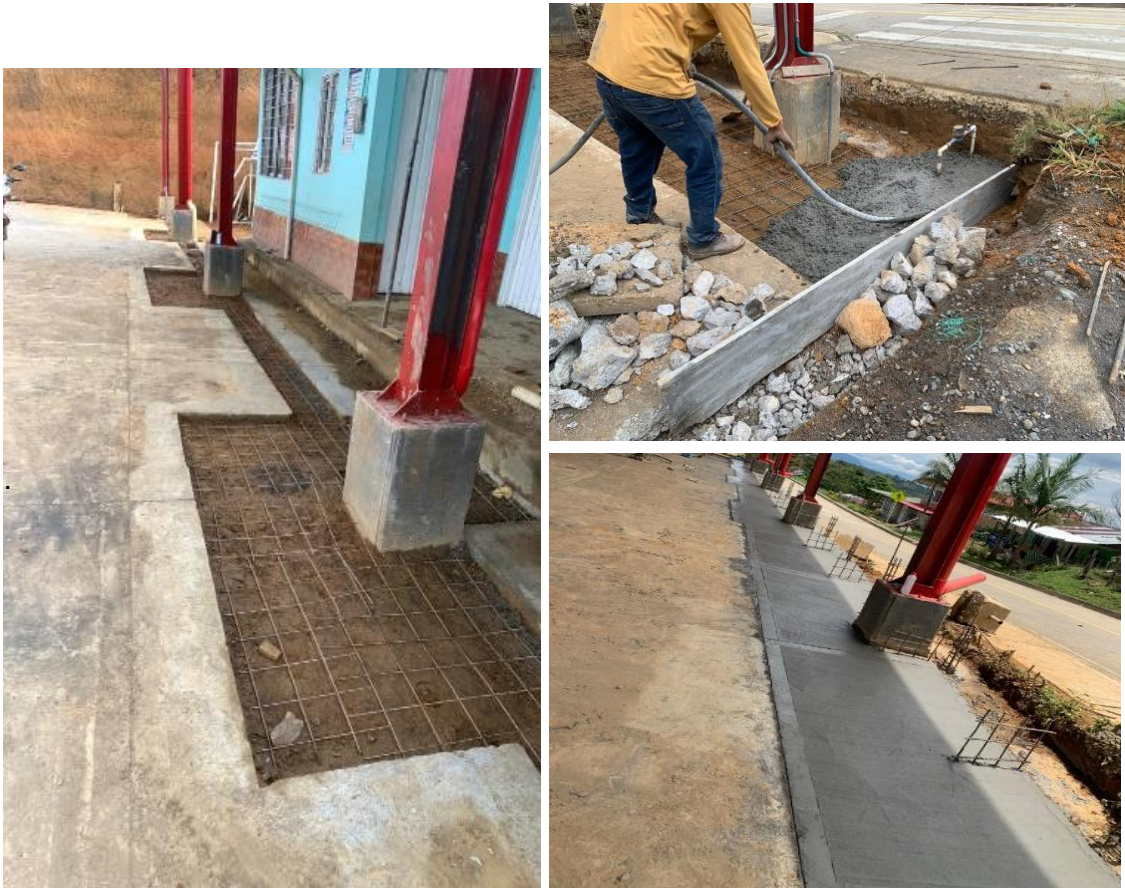
Figura 12. Vaciado de concreto para la losa de la cancha, vibrado y nivelado
