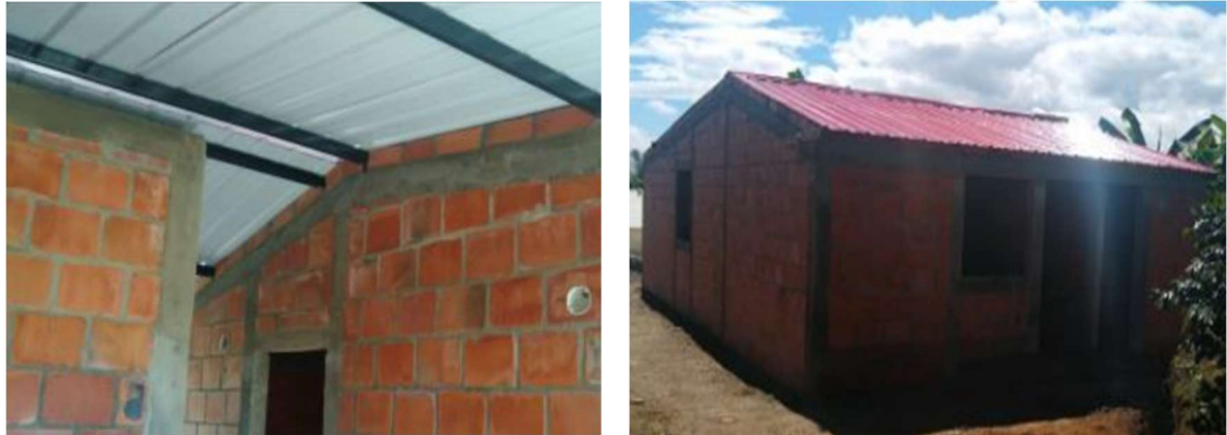
Figura 39. Cubierta en teja de acero
