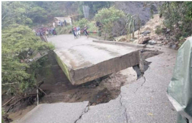
Figura 45. Destrucción del Puente en Río Negro
