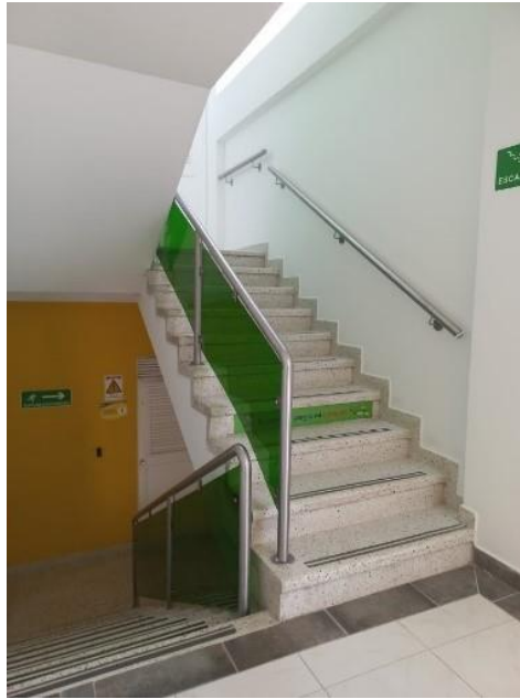
Imagen 13: Barandales con anclaje al suelo y pared (fuente propia)
