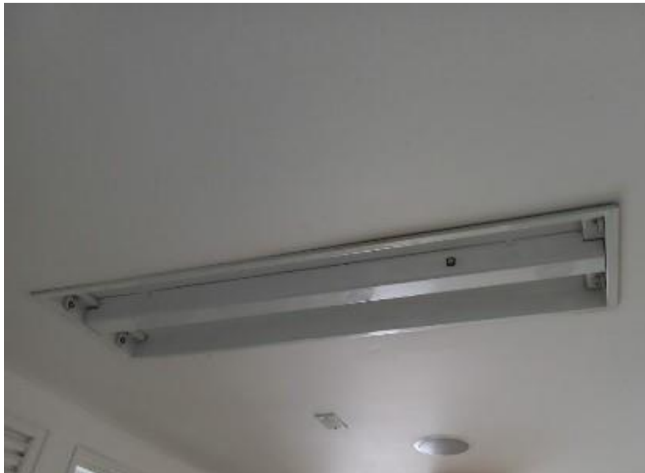
Imagen 10: Lámpara anclada al techo (fuente propia)
