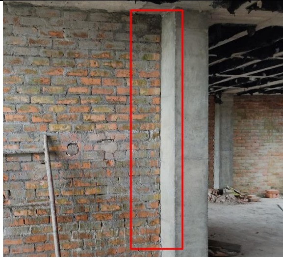
Muros divisorios sin dilatación.
