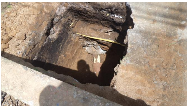
Figura 22. Cámara de inspección domiciliaria. Fuente: Tomada por el pasante
