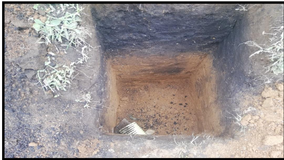
Figura 24. Caja de inspección domiciliaria. Fuente: Tomada por el pasante.
