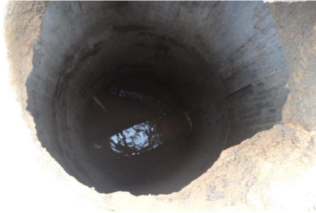
Figura 14. Cámara de inspección. Fuente: Tomada por el pasante
