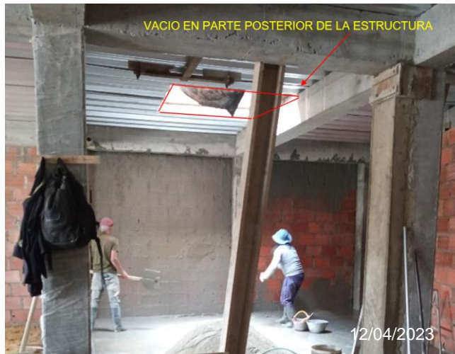
Figura 37. Vacío de estructura – La Ladera
