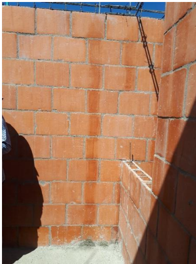
Imagen 24 Rastro del agua sobre el bloque de arcilla en fundición de dovela
