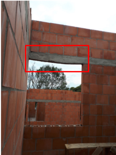
Imagen 35 Pandeo de viga de cubierta
