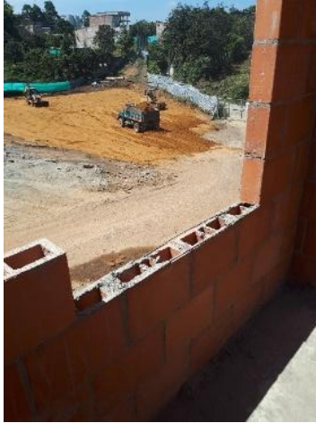
Imagen 33 Derribamiento de piezas de antepecho por sobre esfuerzo
