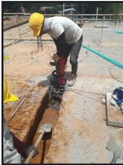
Imagen 16 Error en la Ubicación de Vigas
