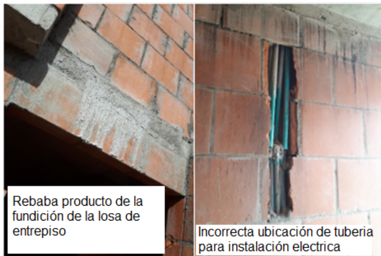
Imagen 23 Rebaba en mampostería y demolición de muros de mampostería por la incorrecta ubicación de tubería
