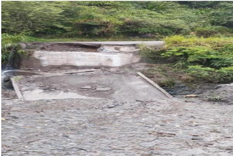
Figura 9 Elementos expuestos sobre el Puente “Los Azules” Vereda Tambo Bajo
