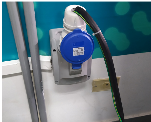
Figura 2.7: Cable de poder enchufado en el suministro de energía de 220 voltios a cinco hilos
