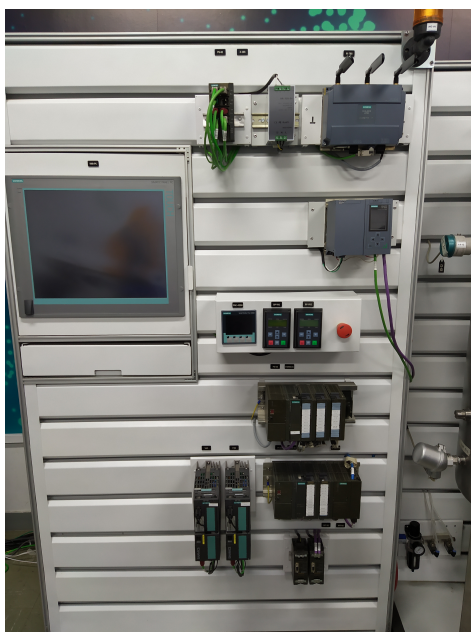
Figura 2.5: Muro de equipos
