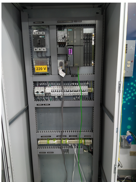
Figura 2.4: Armario de conexiones
