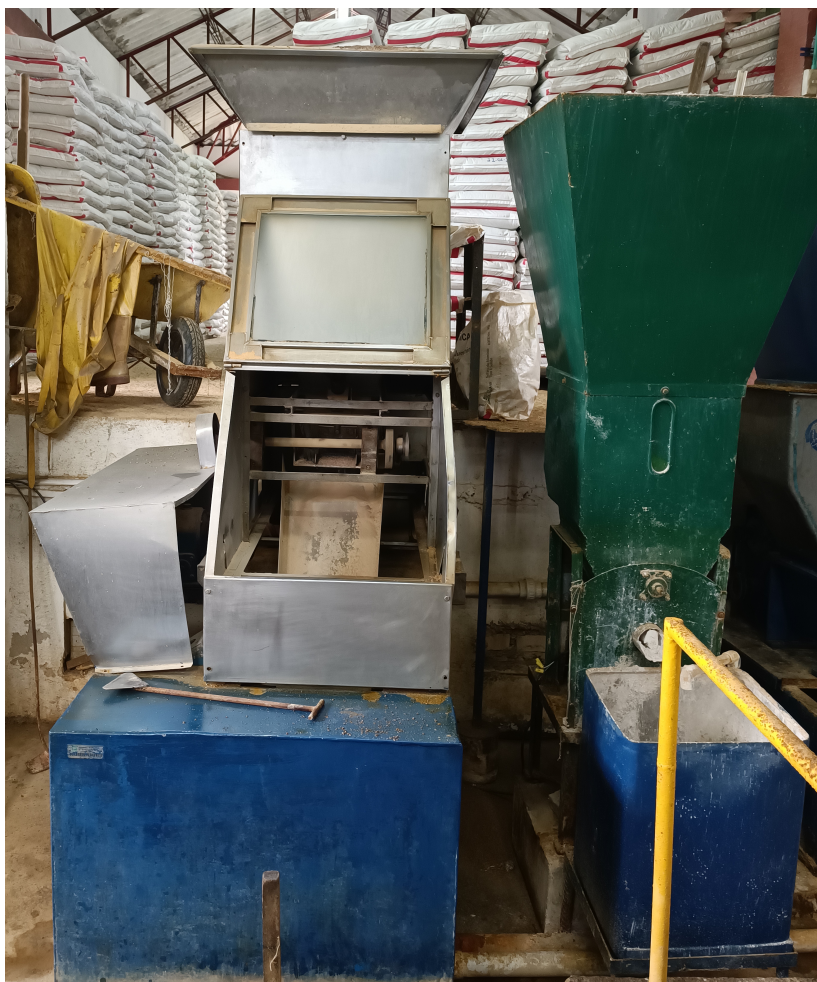
Figura 2.2: Dosificador de coagulante de la planta de tratamiento de Agua "El Tablazo". Fuente propia
