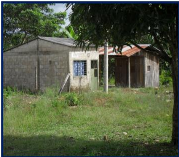
Viviendas en mal estado
