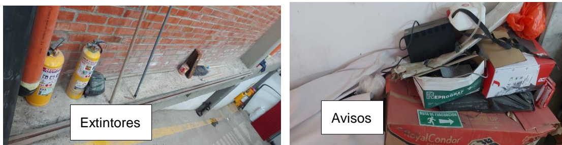
Figura 46. Elementos de seguridad y señalización sin ubicación adecuada.
