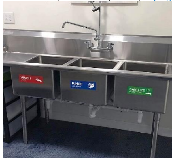
Figura 9. Instalación con tres compartimientos (lavado, enjuague y desinfección).
