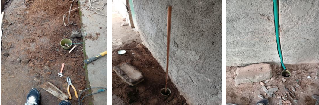
Ilustración 115: puesta a tierra para tablero eléctrico Braimer (cocina)
