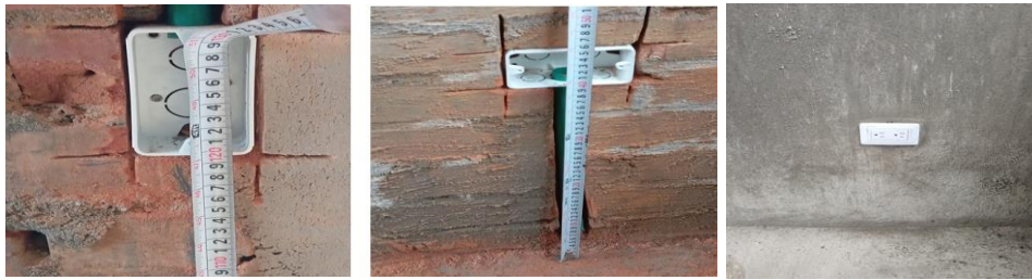
Ilustración 119: toma corriente Braimer (cocina).
