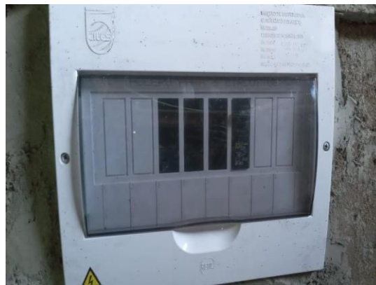
Ilustración 116: tablero eléctrico Braimer (cocina).
