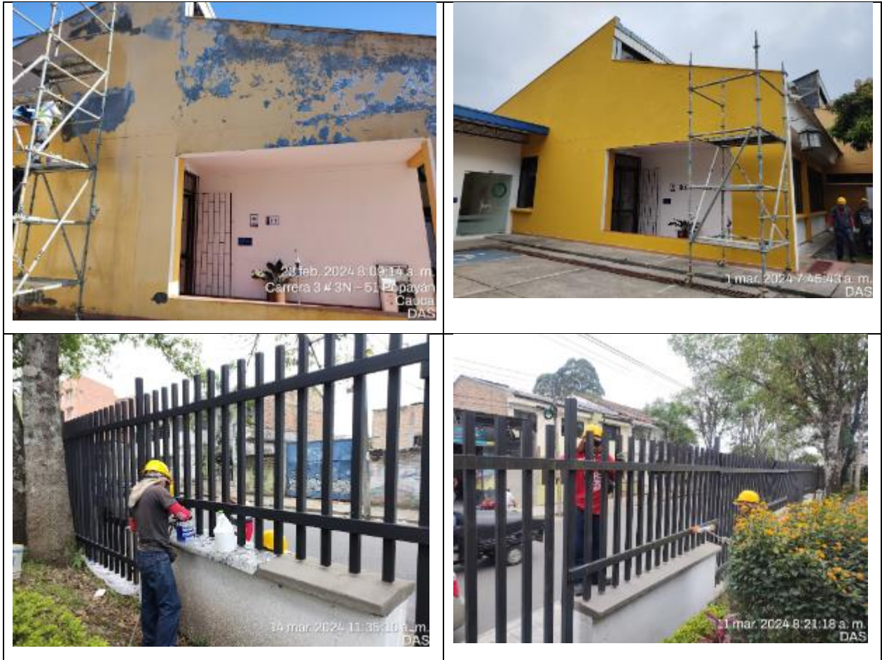
Ilustración 7. Mantenimientos Instalaciones DAS, Universidad del Cauca.
