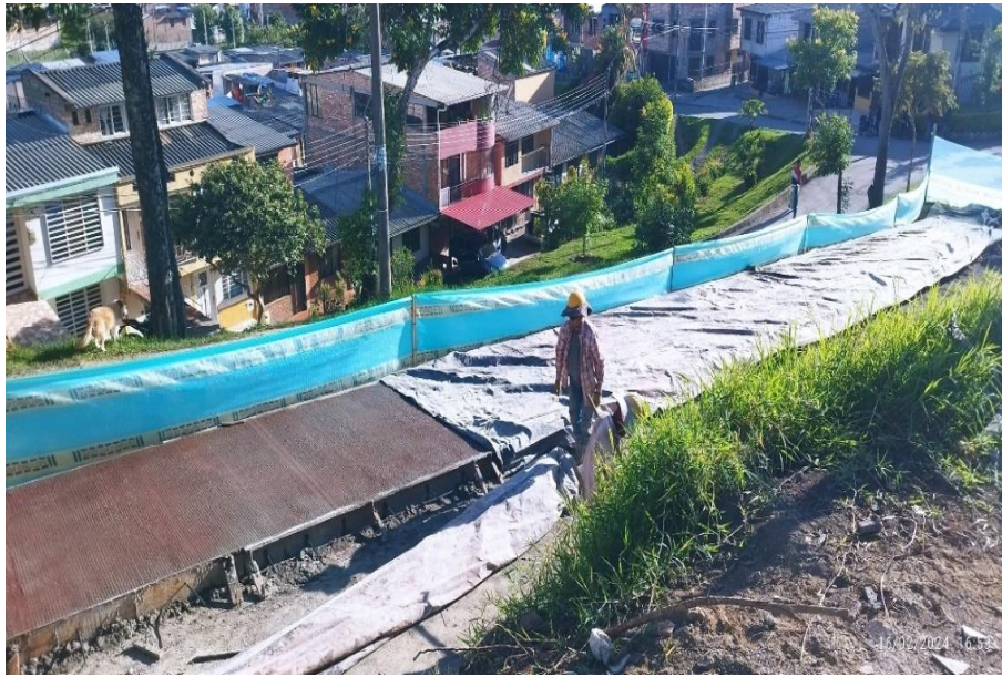
Ilustración 32 Protección de la fundición carrea 40B
