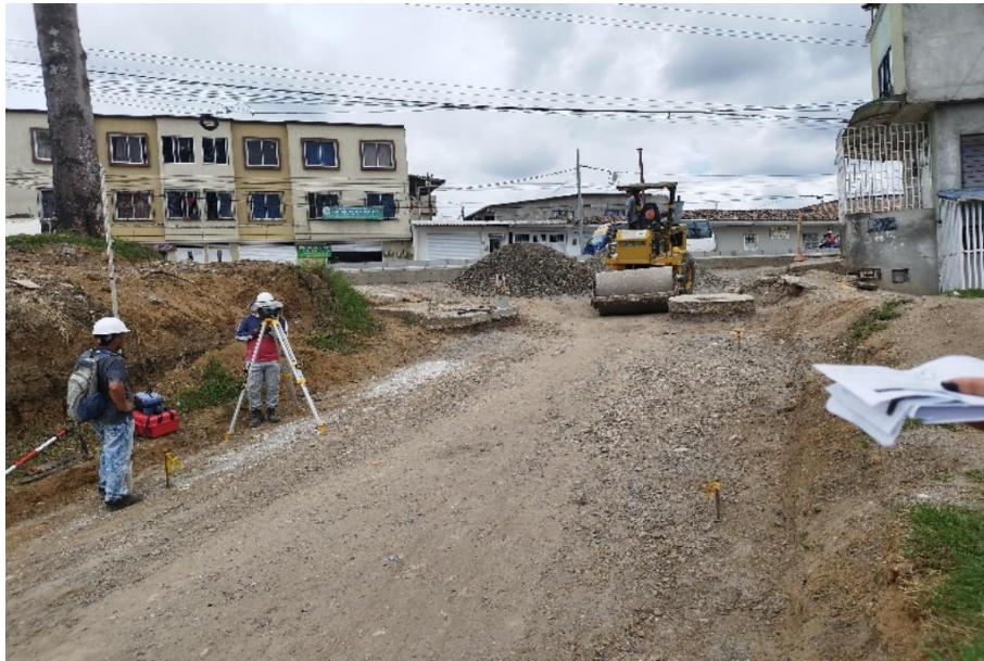
Ilustración 3 Estado inicial boca calle carrera 40B
