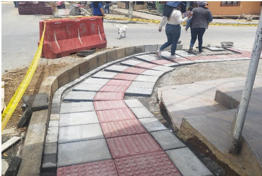
Ilustración 97 Loquetas calle 5ª con carrera 40B
