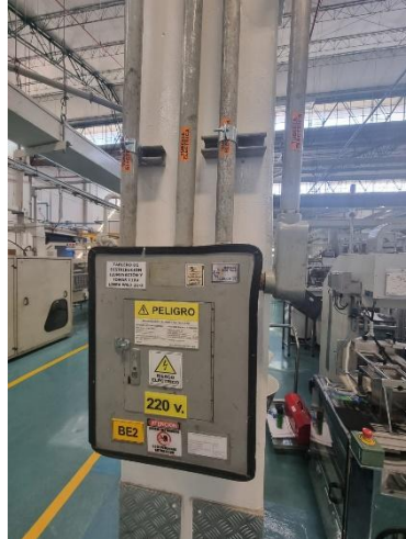
Imagen 10. Caja eléctrica en columna
