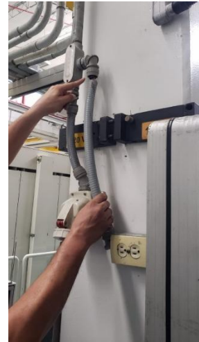
Imagen 11. Tuberías eléctricas y toma corrientes en columna
