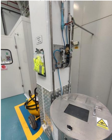
Imagen 9. Equipos de redes anclados a la columna y protección en sus filos
