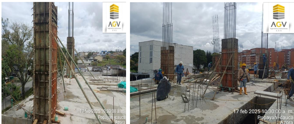
Imagen 12 y 13. Toma de plomo en columna, Edificio AZORA
