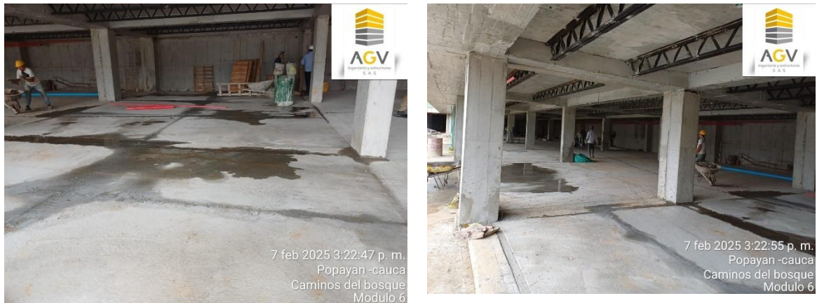
Imagen 25, 26. Juntas de dilatación en pavimentos, Caminos del Bosque
