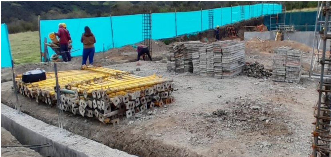
Ilustración 81 Formaleta Metálica en Obra.
