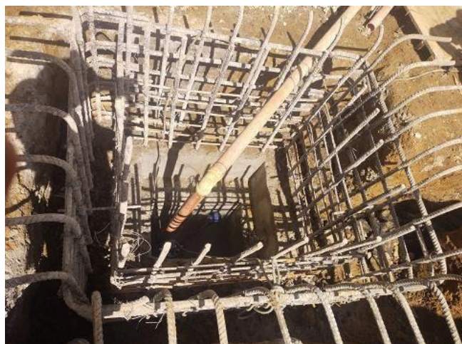
Ilustración 31 Caja pluvial en funcionamiento sistema bombeo
