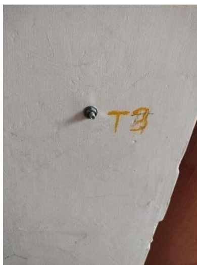
Ilustración 98 Tornillo en el punto de referencia para medir asentamientos
