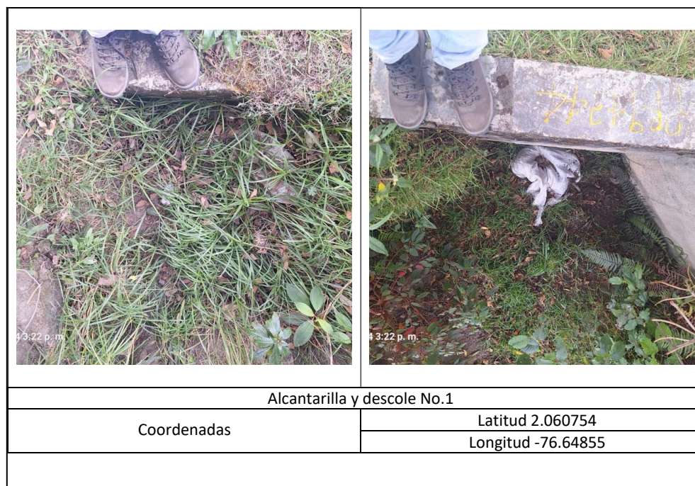
Ilustración 98. Alcantarilla parcialmente tapada No 1 - vereda Chapiloma
