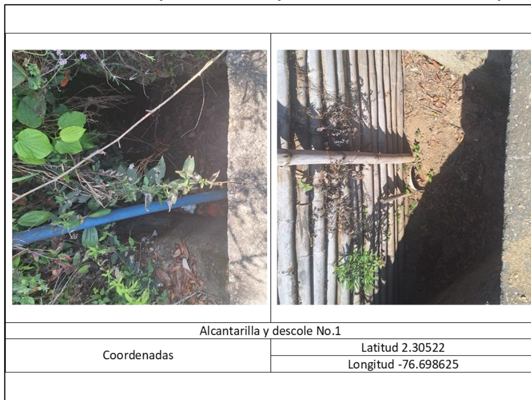
Ilustración 94. Alcantarilla parcialmente tapada No 1-vereda Nuevo Boquerón
