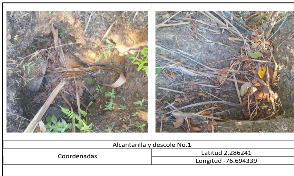
Ilustración 112. Alcantarilla totalmente tapada No 1
