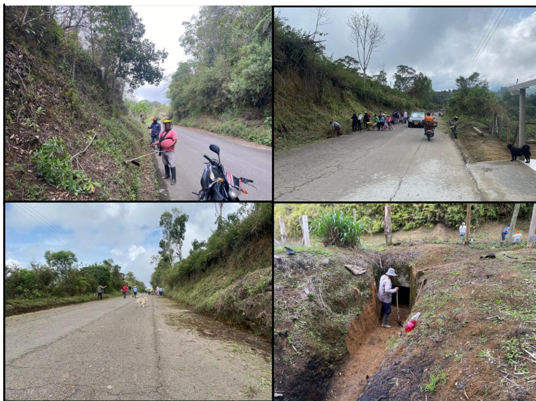
Ilustración 95. Visita de supervisión mantenimiento Nuevo Boquerón
