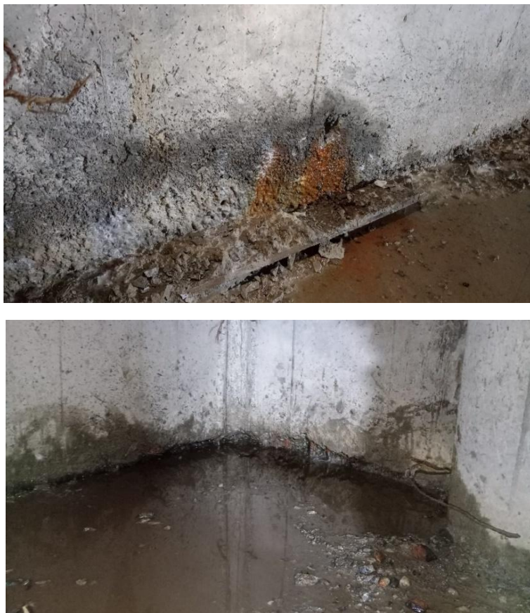
Ilustración 121. Filtraciones identificadas en el sótano.
