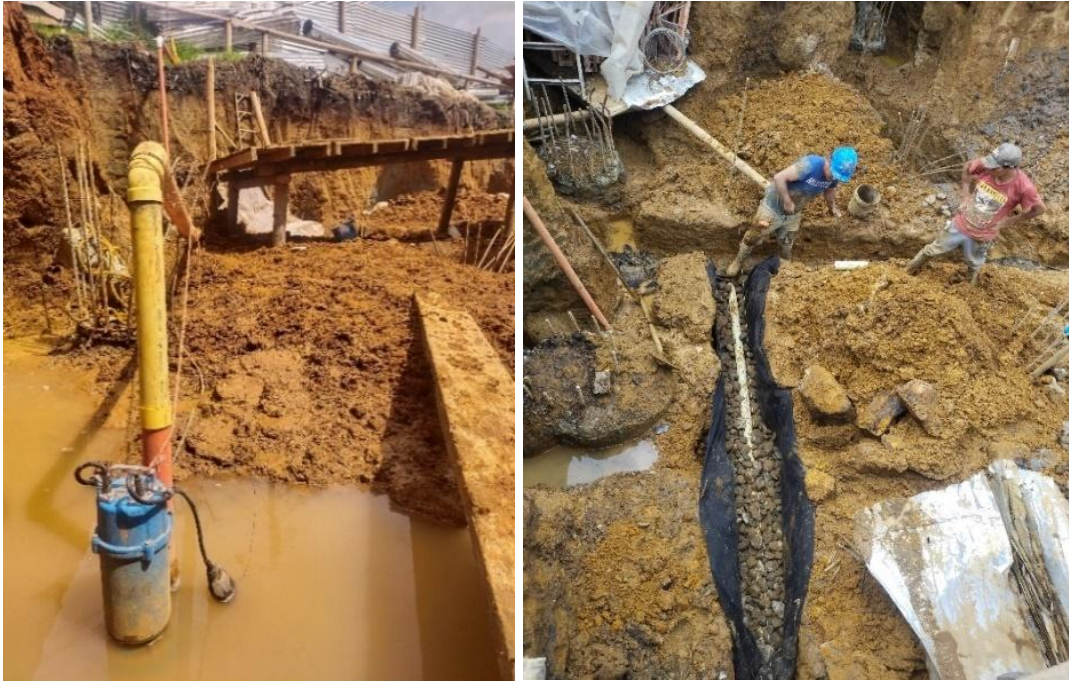
Ilustración 6. Sistema de drenaje y bomba.
