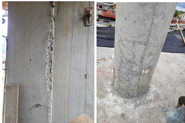
Ilustración 97. Superficies con "nido de abeja" o desprendimiento.
