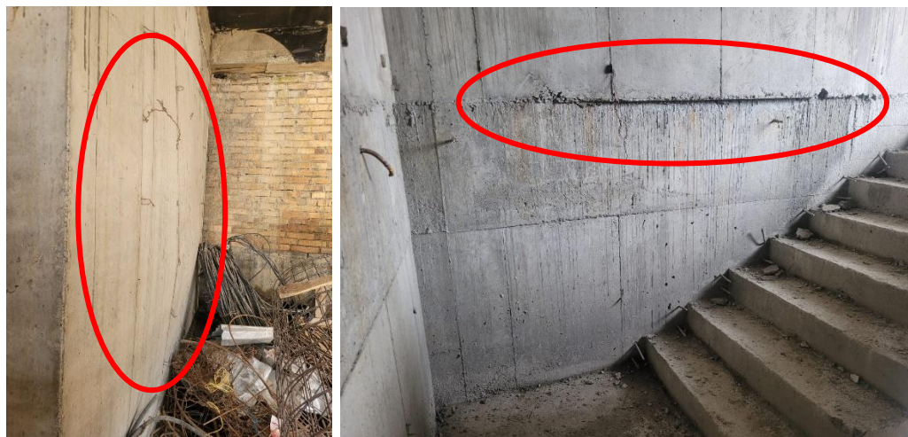
Ilustración 118. Superficies de muros embombadas.
