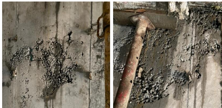
Ilustración 10. Hormigueo en muros estructurales
