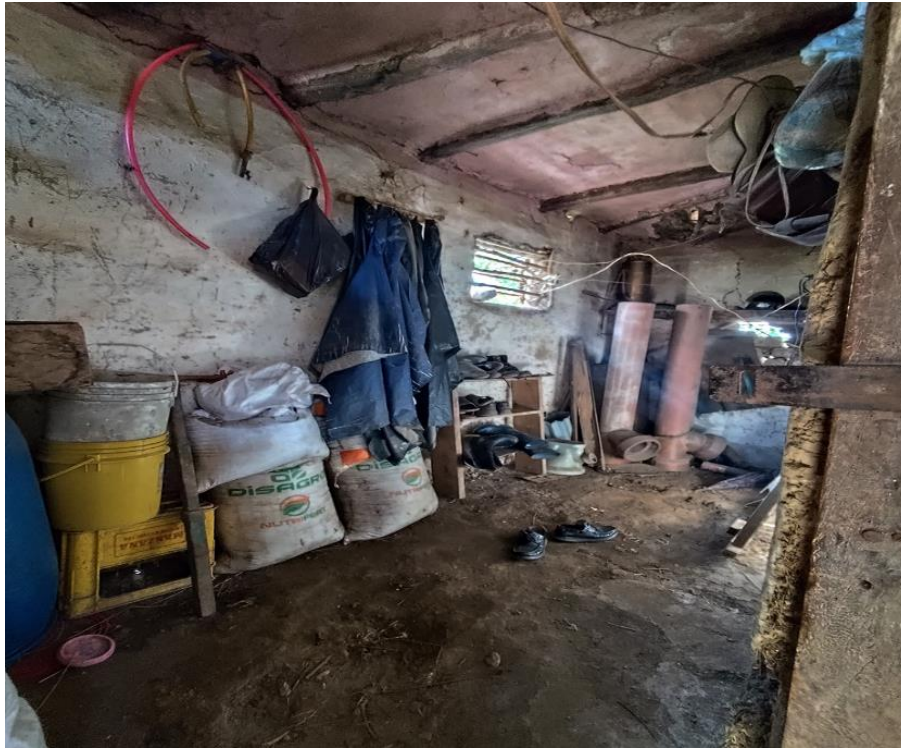
Fotografía 8: Conexiones eléctricas inseguras, exceso de humedad
