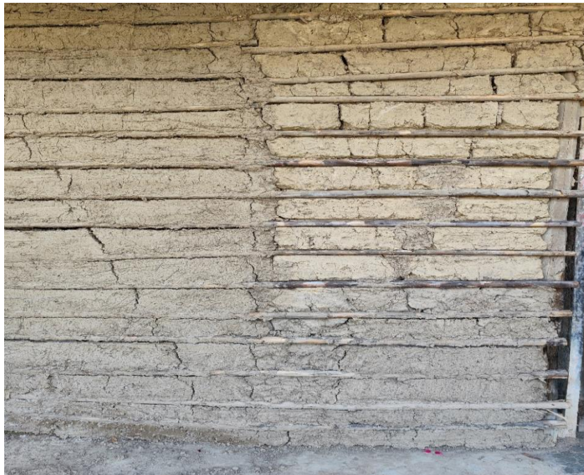
Fotografía 7: Grietas en los muros
