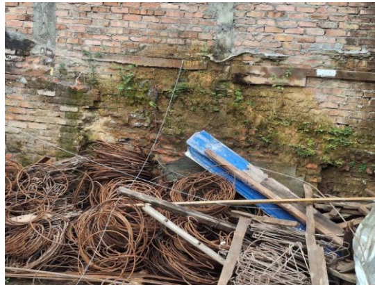
Ilustración 127. Notoria Humedad en Boutique Colindante.
