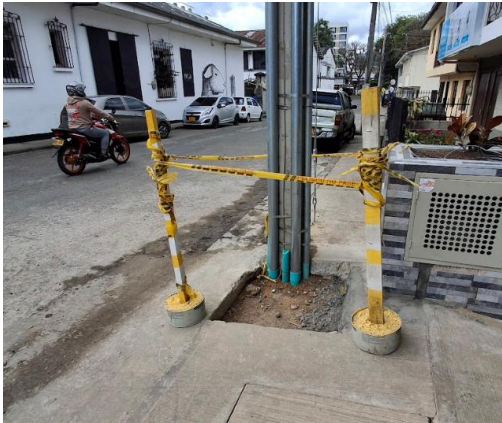
Ilustración 121. Demarcación de Posible Peligro para Peatones.
