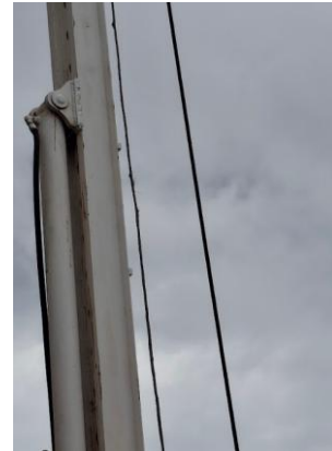
Ilustración 118. Piloteadora con Cableado en Mal Estado.
