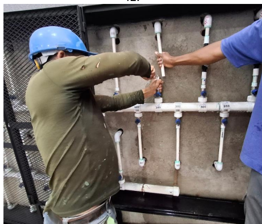
Ilustración 97. Instalación de Contadores de Agua Living 42.
