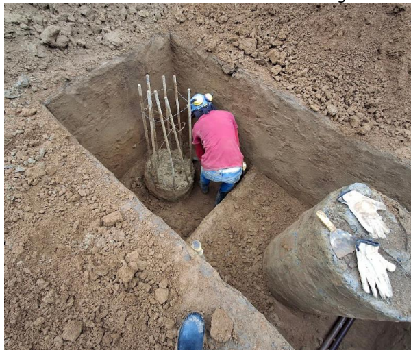
Ilustración 70. Exceso de Excavación Living 49.
