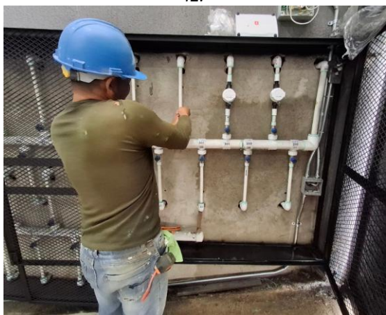
Ilustración 96. Instalación de Contadores de Agua Living 42.
