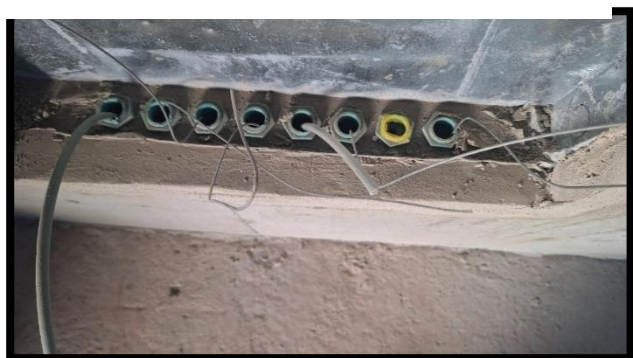
20 - Tubería sin punto a tierra
