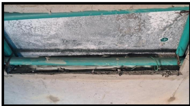
19 - Tubería de comunicaciones sin ser sondeado.
