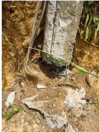
Ilustración 22. Foto de detalle del daño presente en el poste eléctrico de la vereda Santa María
