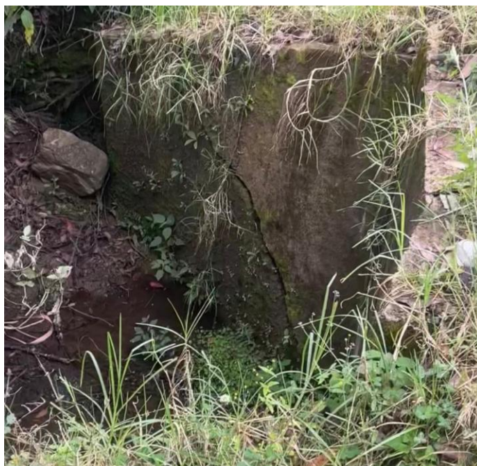
Ilustración 23. Fractura en cabezal de alcantarilla 1.
