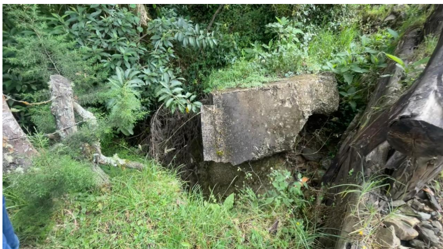
Ilustración 25. Cabezal destruido alcantarilla 2.
