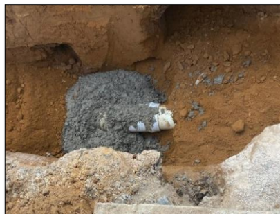
Ilustración 7-107 Anclaje de reducción de 6" a 3"- carrera 9 con calle 73N Fuente. Elaboración propia.
