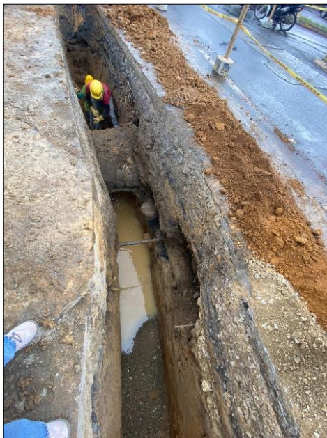
Ilustración 7-129 Daño de alcantarillado existente- Carrera 9 con 73N Fuente. Elaboración propia
