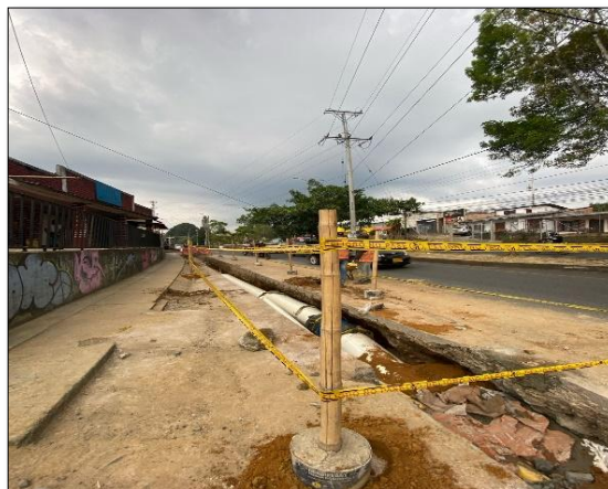
Ilustración 7-12 Señalización Carrera 9 entre calle 70N y 71N Fuente. Elaboración propia.
