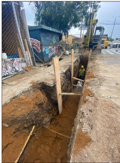
Ilustración 7-100 Colapso de andén- carrera 9 con calle 73N Fuente. Elaboración propia.
