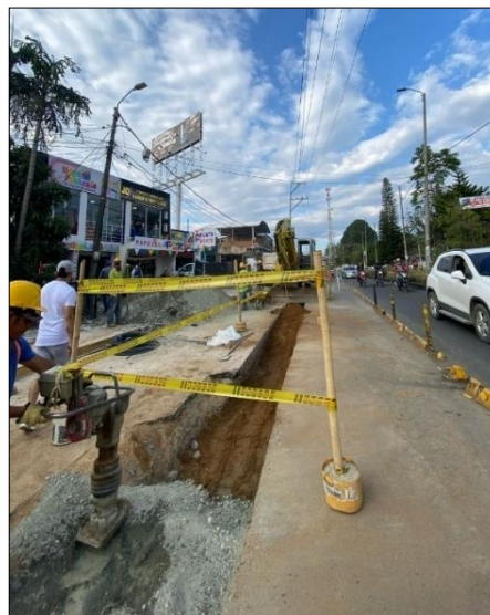
Ilustración 7-31 Señalización Carrera 9 entre calle 70N y 71N Fuente. Elaboración propia.
