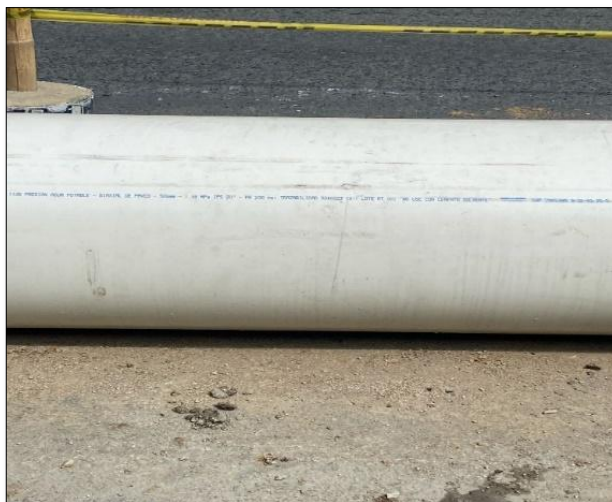
Ilustración 7-24 Tubería defectuosa de 20". Carrera 9 entre calle 70N y 71N Fuente. Elaboración propia.
