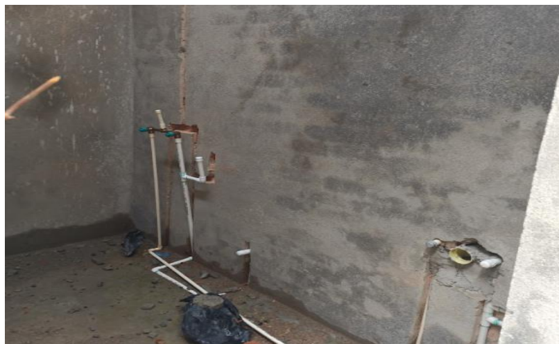
Ilustración 28: Instalación hidráulica y sanitaria.
