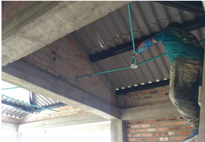
Ilustración 27: Instalación eléctrica para luminaria.
