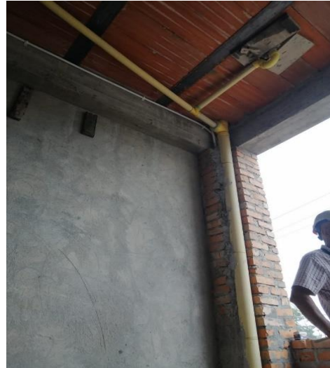
Afectación a viga por el paso de tubería sanitaria
