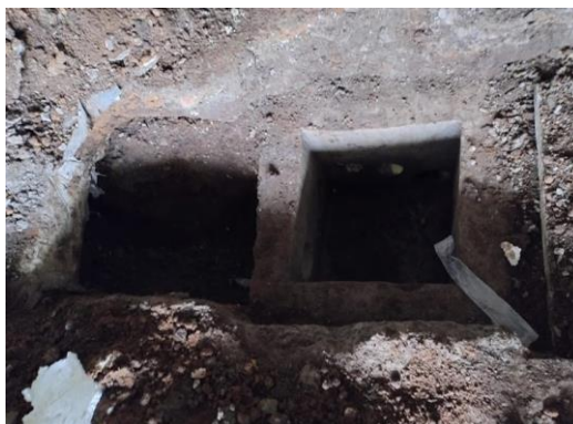
Caja de inspección
