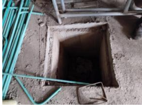
Caja de inspección
