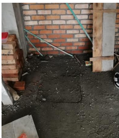
Ubicación caja de inspección
