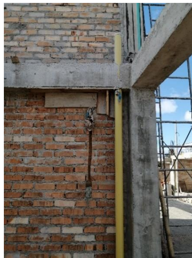
Afectación de viga por el paso de tubería
