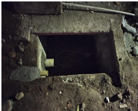
Caja de inspección sin terminar.
