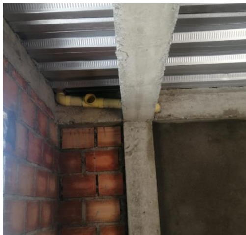
Afectación a viga por el paso de tubería sanitaria
