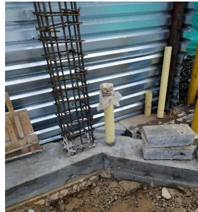
Afectación de vigas por el paso de tubería sanitaria
