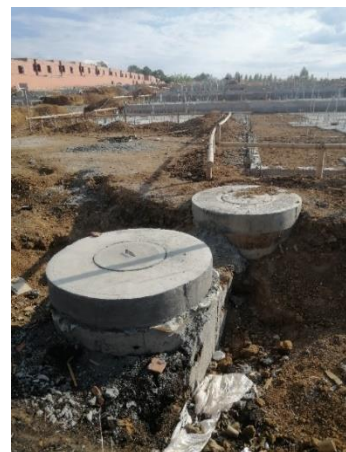
Cámaras de inspección internas
