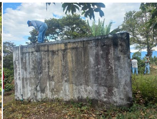
Fotografía 5 Tanque El Porvenir Fuente: Elaboración propia
