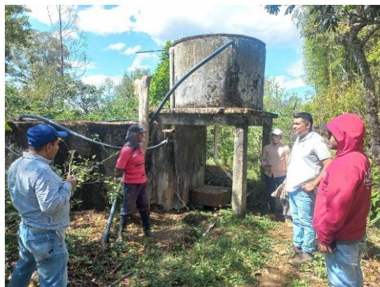
Fotografía 3 Tanque El Cedro Fuente: Elaboración propia
