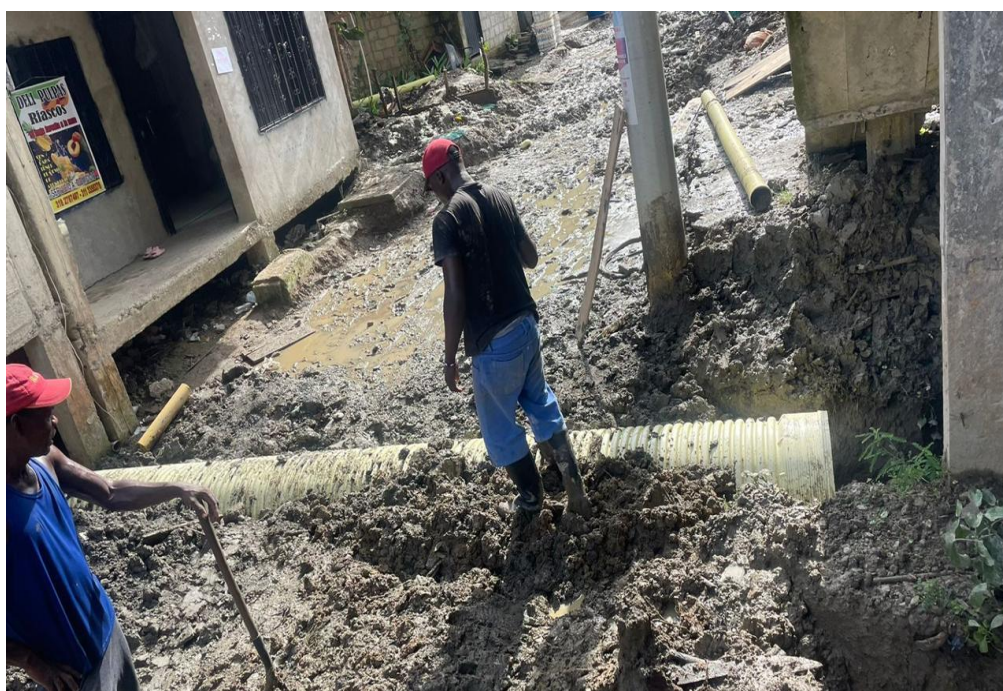
Ilustración 29 Colector de aguas lluvias
