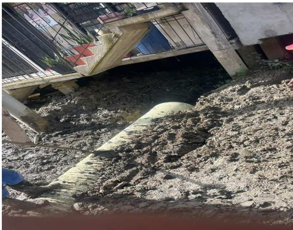
Ilustración 30 Colector de aguas lluvias
