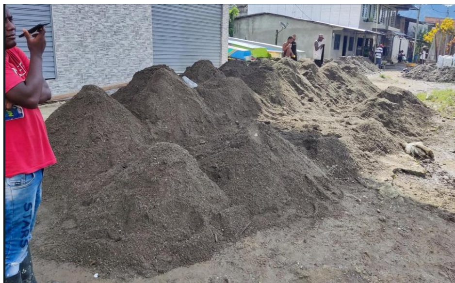
Ilustración 35 Almacenamiento del material granular
