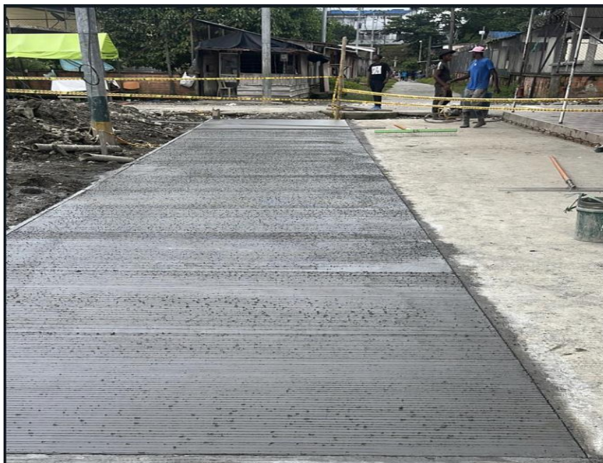
Ilustración 20 Macro texturizado del concreto
