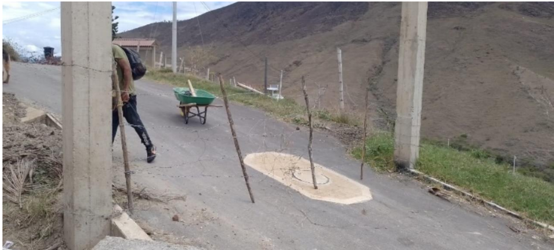
Ilustración 6. Estado inicial del acceso principal
