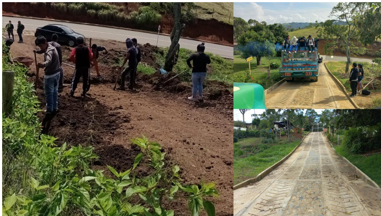
Figura 20. Placa huella de ingreso al Centro de Formación
