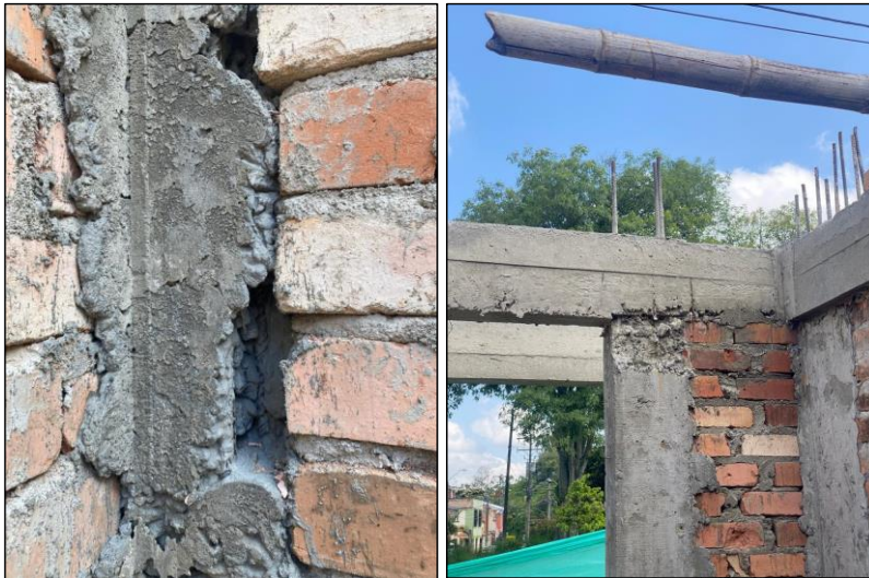
Ilustración 32. Segregación del concreto. Fuente: Elaboración propia.
