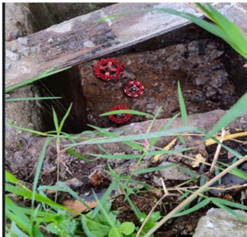
Figura 26. Válvulas del primer punto
