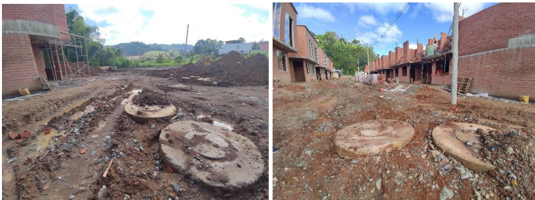
Imágenes 7.9.3 Recamaras de inspección, pluvial y sanitaria
