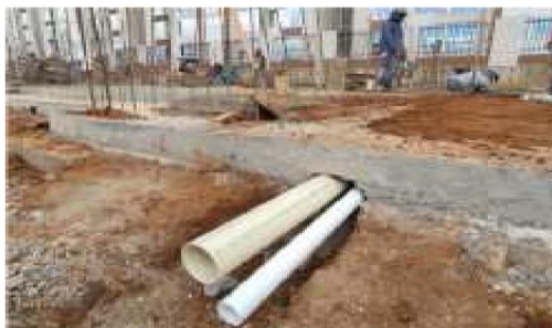
Imagen 7.6.1 Tubería sanitaria de conexión 4" y 2"
