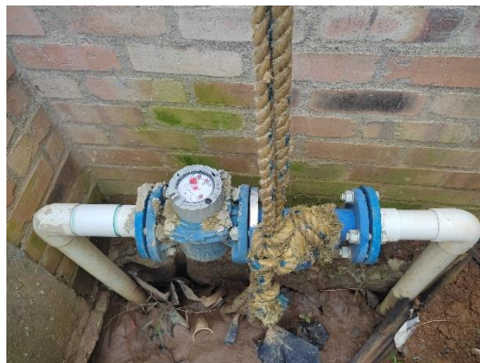
Imagen 7.9.2 Macro medidor agua potable del proyecto
