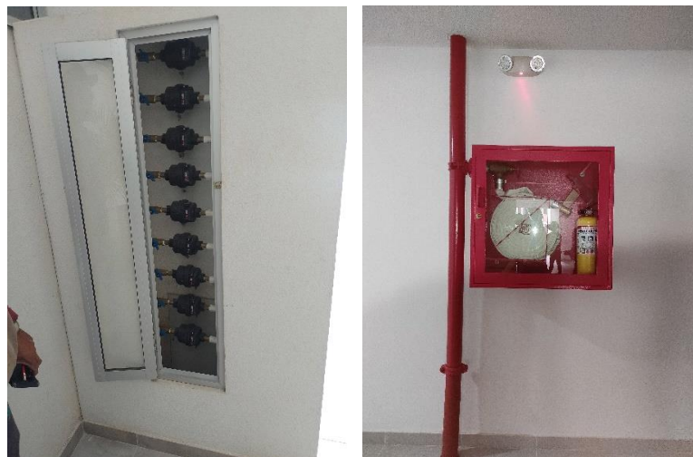
Imágenes 7.10.5 Armario Medidores, Armario contra incendios
