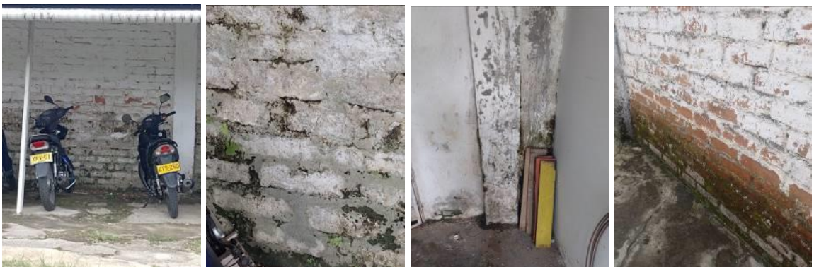
Imágenes 7.7.1 humedad evidenciada dentro de la penitenciaría
