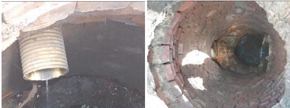
Imágenes 7.7.8 recorrido sobre calle 13 a la cra 11ª monumento chirimía
