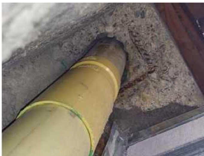
Imagen 7.1.4 Tubería de 3" en Viga cerca al nodo
