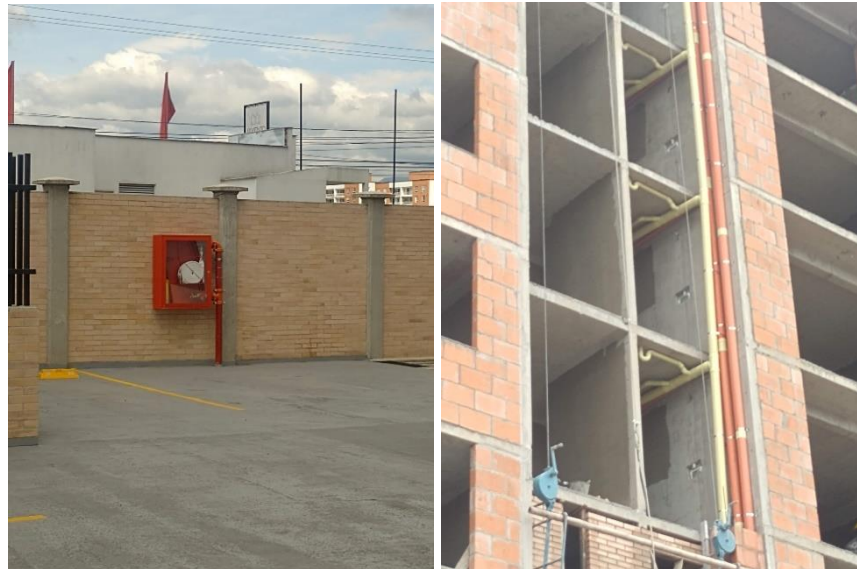
Imágenes 7.10.2 Gabinete sistema contra incendios y disposición de tuberías
