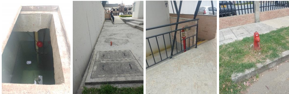
Imágenes 7.10.4 Tanques subterráneos, siamesa e hidrante
