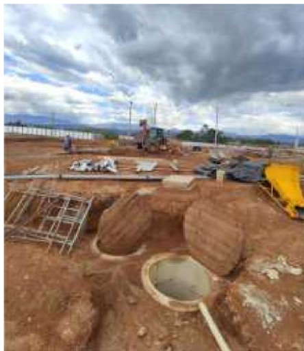
Imagen 7.6.8 Recámara pluvial y sanitaria
