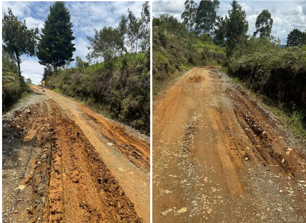
Figura 113. Deterioro Vial por Tránsito Pesado y de Maquinaria.
