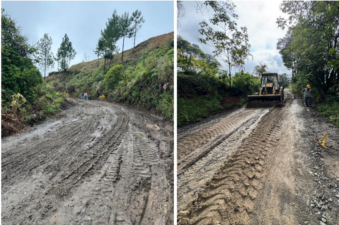
Figura 117. Condiciones del Terreno Tras Lluvias y Tareas de Recuperación Vial.
