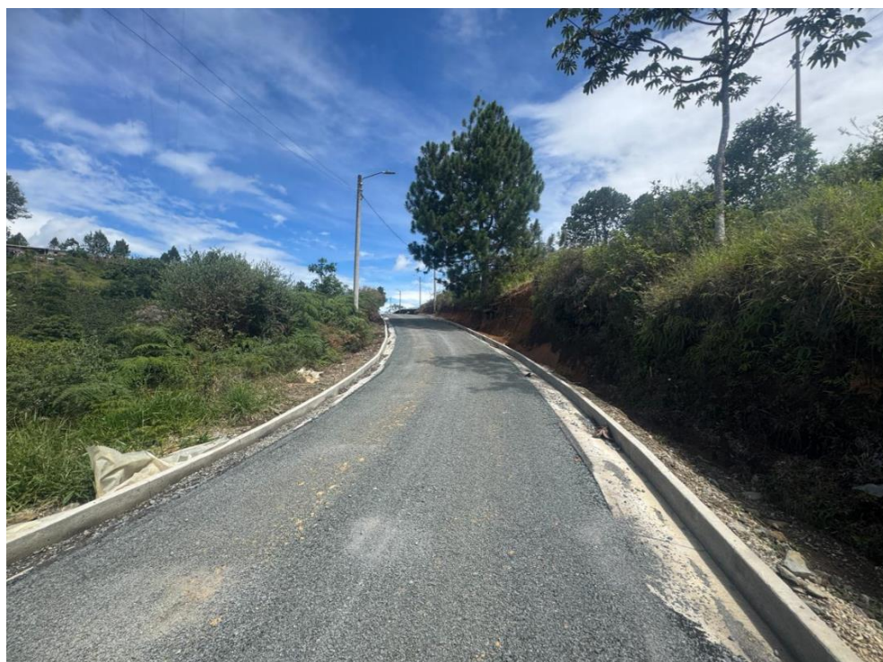
Figura 103. Tratamiento Superficial - Tramo 2: K14+983,4 y K15+174,4.
