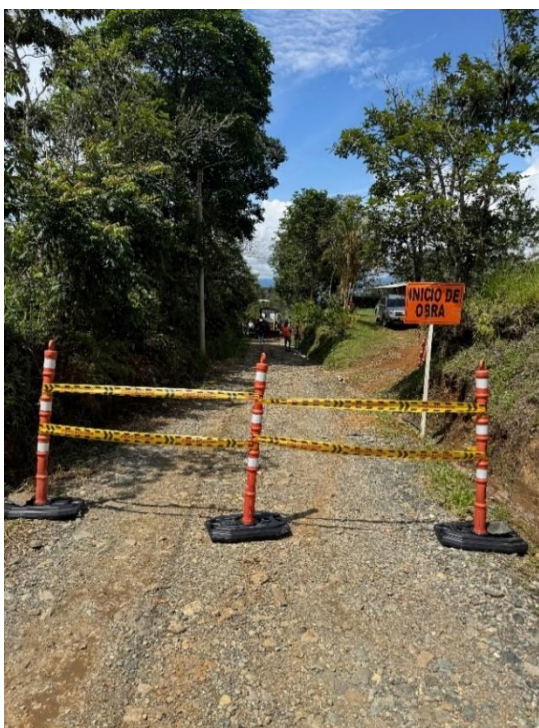
Figura 11. Señales Preventivas de Obra.
