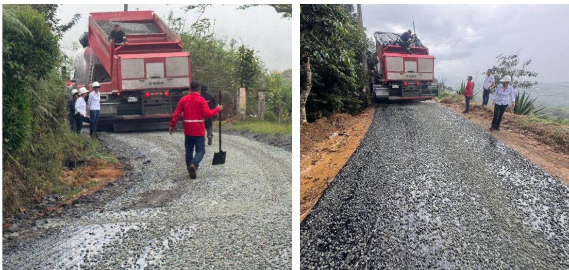
Figura 118. Problemas en la Instalación de TSD.
