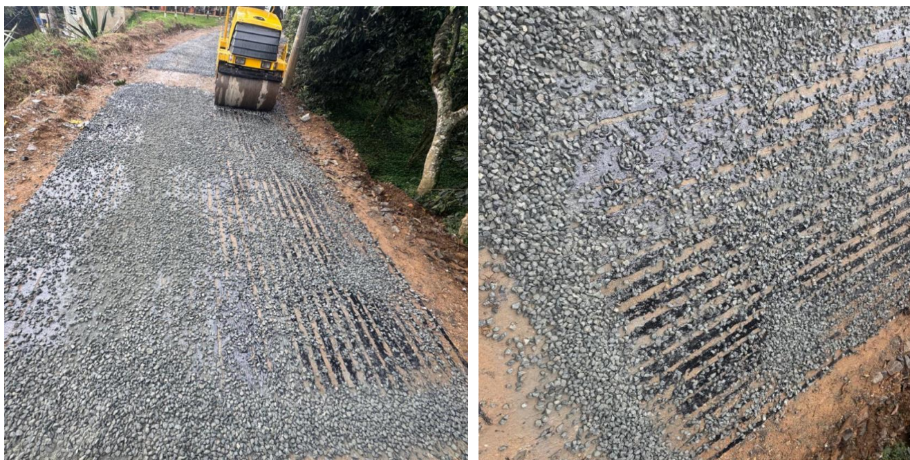
Figura 119. Fallas mecánicas en equipo dispuesto para instalación de TSD.
